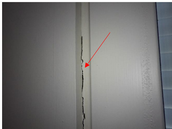
Kuva 31. Ikkunan välisen levyrakenteen ja ikkunapuitteen liittymissä halkeamia
