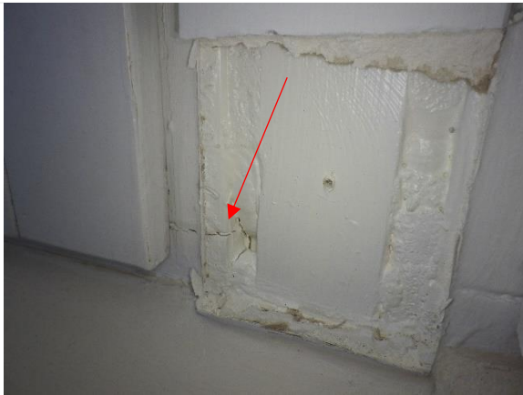
Kuva 17. Ikkunan välinen rakenne tiivistetty. Tiivistyksessä halkeama
