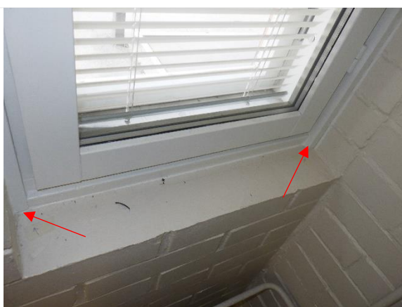
Kuva 12. Sos tila 188 ulkoseinä, vuotokohdat nuolella
