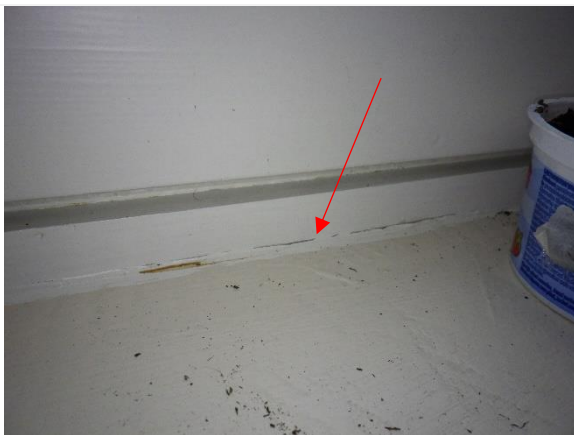
Kuva 28. Ikkunalistoituksessa halkeamia, ei havaittu vuotoja
