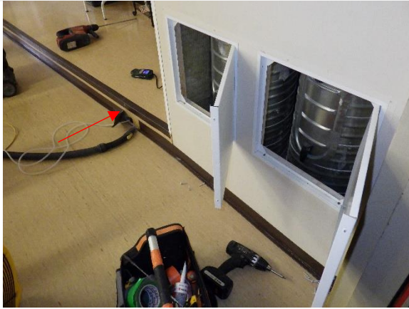
Kuva 20. Yleiskuva IV-koteloista, opettajan korokkeesta sekä kohdasta (nuoli), mihin merkkiainekaasu syötettiin
