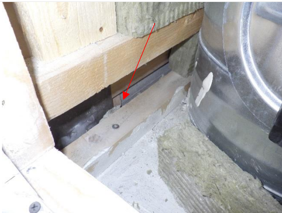
Kuva 19. IV-kotelon tiivistys on toteutettu runkorakenteeseen, ei betonikorokkeeseen (nuolella osoitettu betonirakenne)
