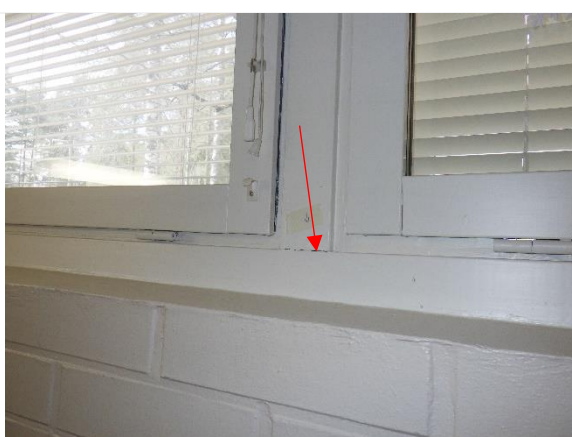
Kuva 14. sostila 188, vuotokohta nuolella
