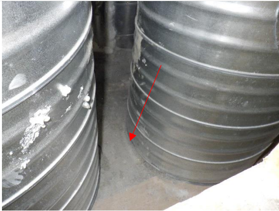
Kuva 22. IV-kotelon lattiapintaa ei ole tiivistetty
