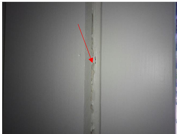
Kuva 29. Ikkunan välisissä rakenteissa halkeamia, havaittiin vuotoja
