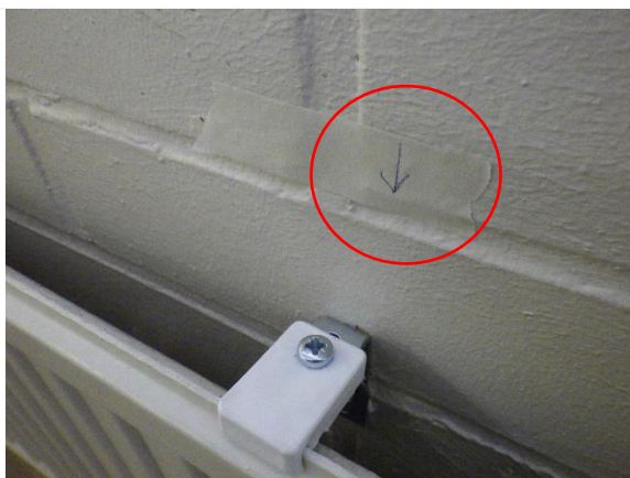
Kuva 10. Vuotokohdat on merkattu teipein
