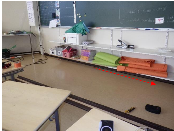
Kuva 23. Yleiskuva korokkeesta. Selkeitä vuotoja havaittiin nuolen kohdalta oikealle. Lattissa teippi, josta vuoto alkaa nuolen suuntaan
