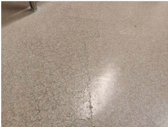
Kuva 2. keittiön akryylibetonipinnoitteessa paikallisia vaurioita ja halkeamia.
