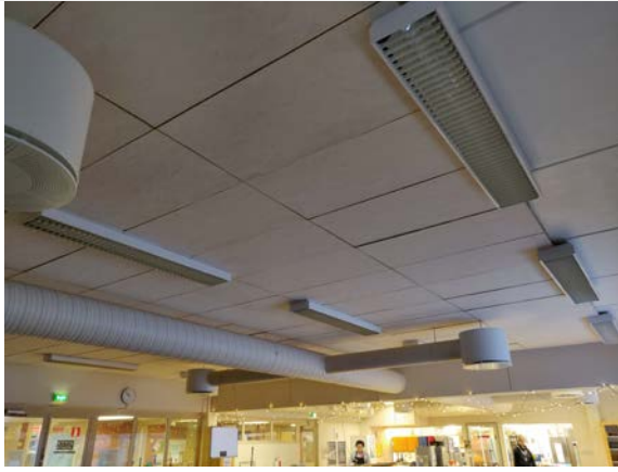
Kuva 10. Ruokasalin alakatossa reunapinnoittamattomia akustointilevyjä, jotka ovat mahdollinen sisäilman kuitulähde.
