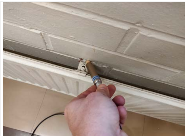
Kuva 7. Ulkoseinärakenteeseen laskettu merkikäs kulkeutui sisäilmaan patterin kannakkeista (halkeama sisäkuoressa)
