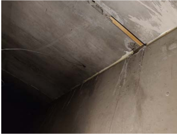
Kuva 4. keittiön alakaton yläpuolella palkin ja ontelolaatan rajapinnat tiivistämättä
