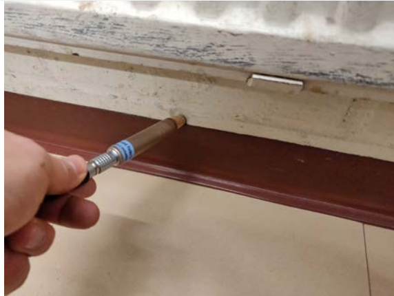
Kuva 8. Ulkoseinärakenteeseen laskettu merkikikaasu kulkeutui sisäilmaan alapohjan ja ulkoseinän rajapinnasta
