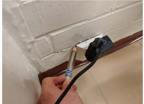
Kuva 9. Ulkoseinärakenteeseen laskettu merkikikaasu kulkeutui sisäilmaan sähkörasiasta
