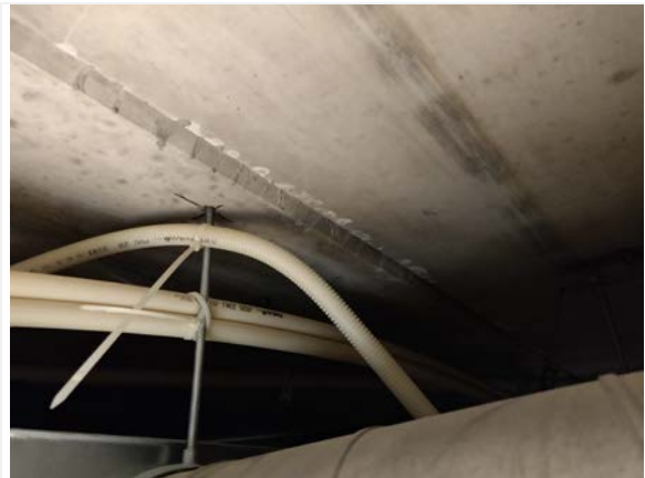
Kuva 3. Keittiön alakaton yläpuolinen tila. Ontelolaatan saumasta valunut tasoitetta edellisen remontin yhteydessä.
