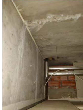
Kuva 5. keittiön alakaton yläpuolella palkin ja ontelolaatan rajapinnat tiivistämättä
