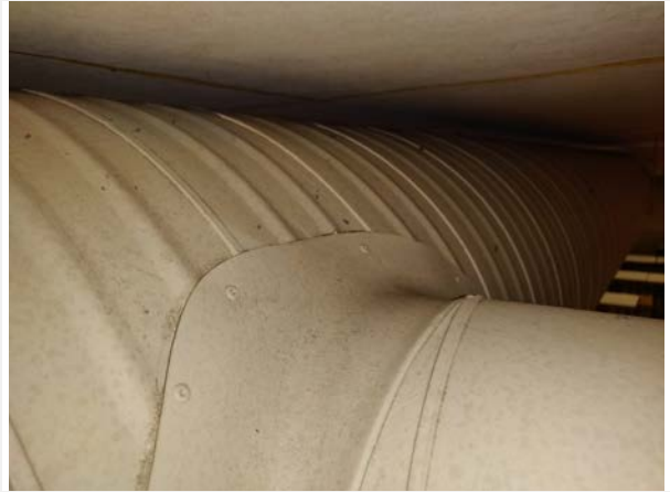
Kuva 11. IV-kanavien päällä pölyä, joka osittain on tarttunut kanavan pintaan.
