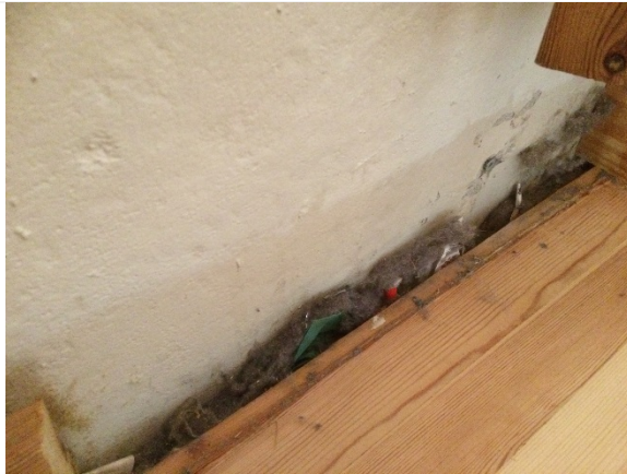
Kuva 4. Pölykertymää ja roskia jalkalistan takana.
