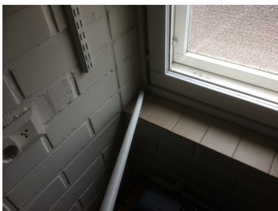
Kuva 23. Merkkiainemittauksessa ilmavuotoa ikkunaliitoksessa
