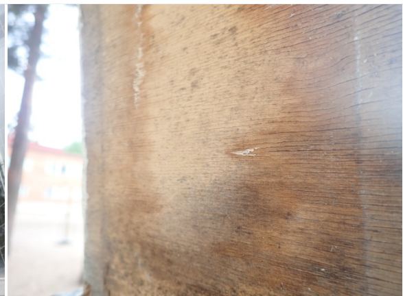
Kuva 16. Ikkunanvälien levytykset tummuneita sisäpinnaltaan
