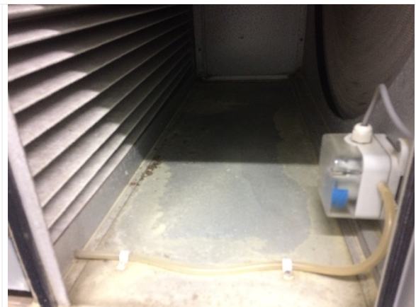
Kuva 34. Suodattimen jälkeen siitepölyä ja kuolleita hyönteisiä.
