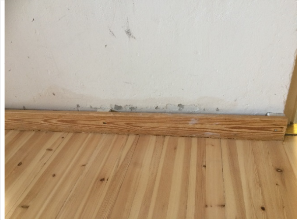
Kuva 12. Pinnoitevaurio seinän alareunassa.
