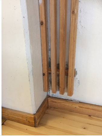
Kuva 11. Pinnoitevaurio pilarin vieressä
